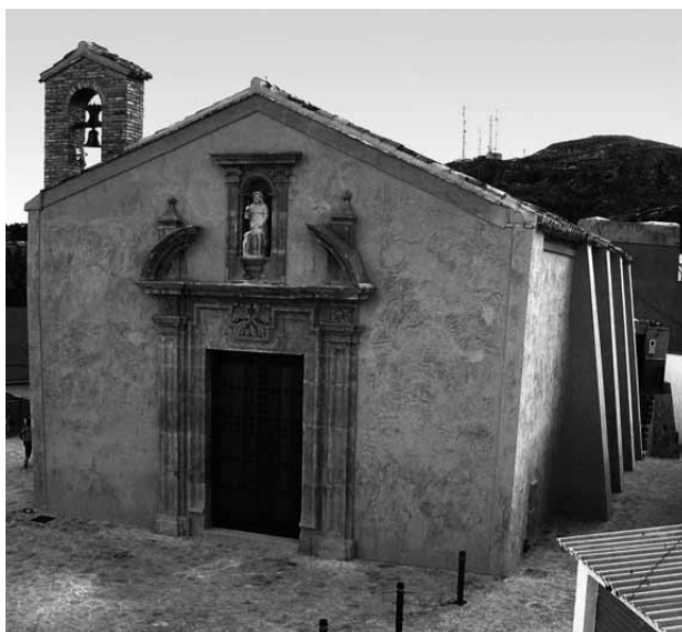
Lámina 2. Exterior de la ermita después del tratamiento de restauración. (Foto: A. Galindo).
