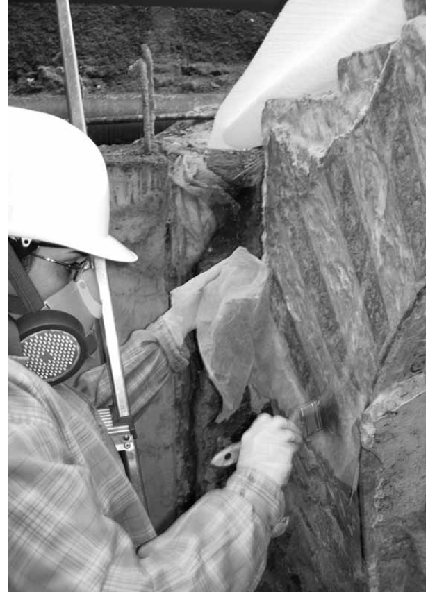
Lámina 1. Proceso de protección del arco del mihrab del muro de la qibla del oratorio de San Juan de Dios. (Foto: M. Quiñones).
