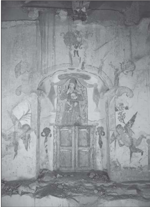
Lámina 20: Fase I. Vista general del altar-hornacina en el que se aprecian depósitos de cemento, yeso y suciedad generalizada.
