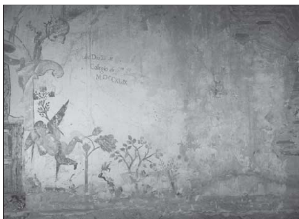
Lámina 29: Fase I. Vista general de la escena campestre (panel n° 3) en el que la suciedad y el desprendimiento de la capa pictórica en algunas zonas oculta la parte inferior de las imágenes.
