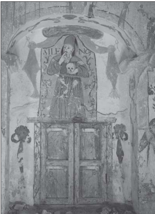
Lámina 22: Fase I. Detalle del altar-hornacina afectado en la parte superior por «chorretes» y techadas de cemento y suciedad generalizada.
