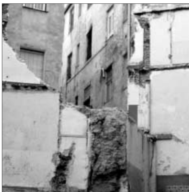
Lámina 3. Sección de la muralla conservada como medianería. Obsérvese el tapial calicastro y el adarve fosilizado (prolongación de la calle Brujera) como patio de luces.
